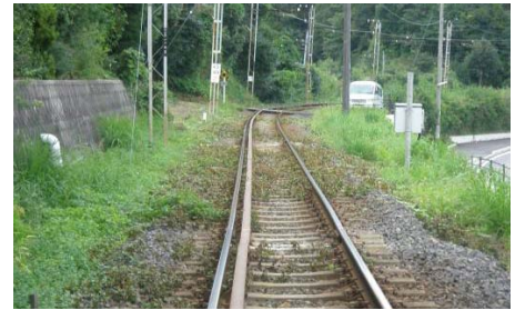
写真 1-1 路盤の劣化（噴泥）
