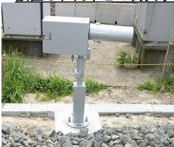
踏切障害物検知装置
